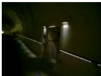
Handlauf mit integrierter Orientierungsbeleuchtung
