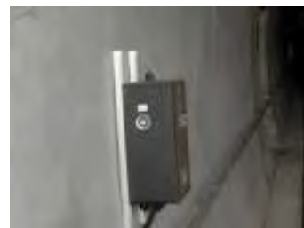
Einschalter für Beleuchtung
