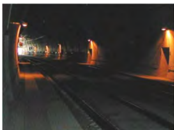
Ausführung als „Kofferleuchten“
